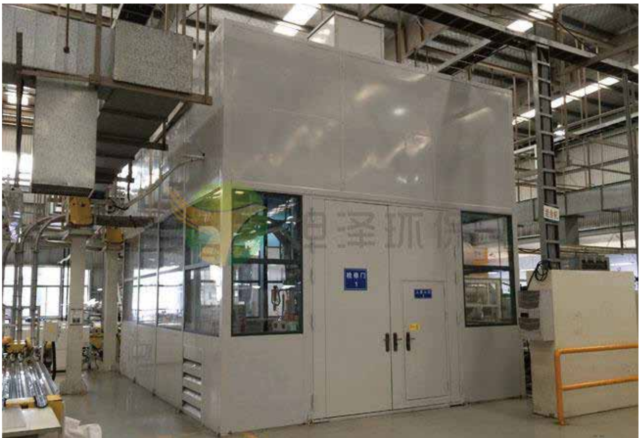
上海宝钢制盖高速冲床降噪工程（二期）
